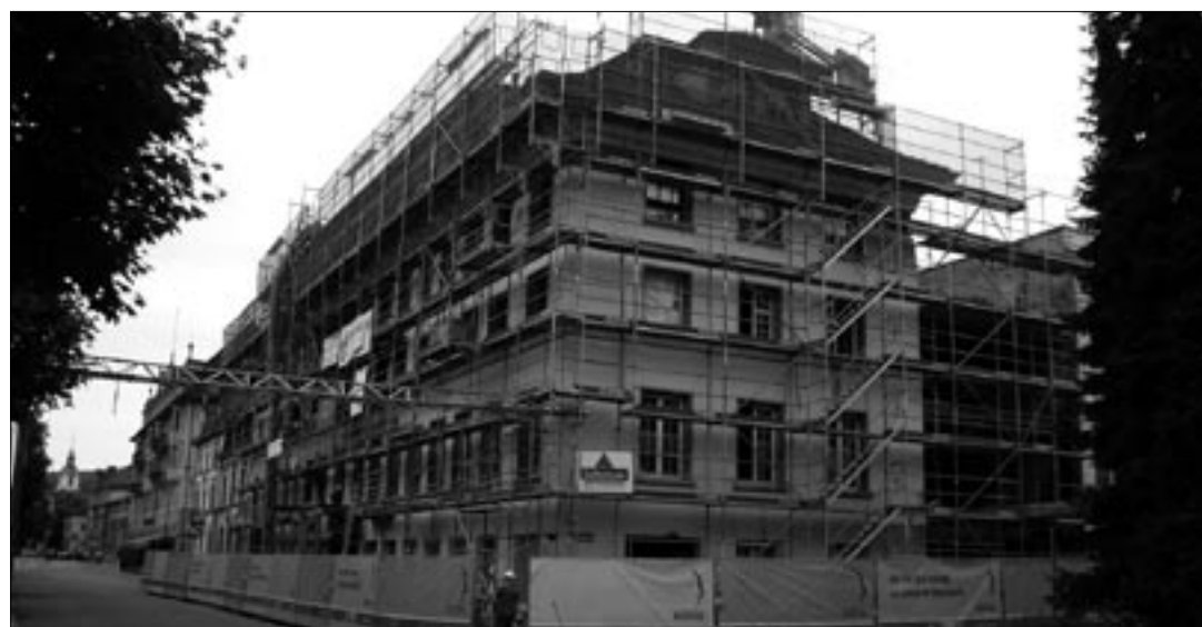
Siège principal de l'ABS à Olten en travaux. «Au cours des deux dernières décennies, la signification du terme «alternatif» a évolué. Des notions comme «esprit pionnier», «autogestion», «mouvement antinucléaire», «antimilitarisme» ont fait place à l'image d'un établissement qui se considère comme une «Banque à visée écologique et sociale» et qui travaille de manière professionnelle.» (photo mad)
