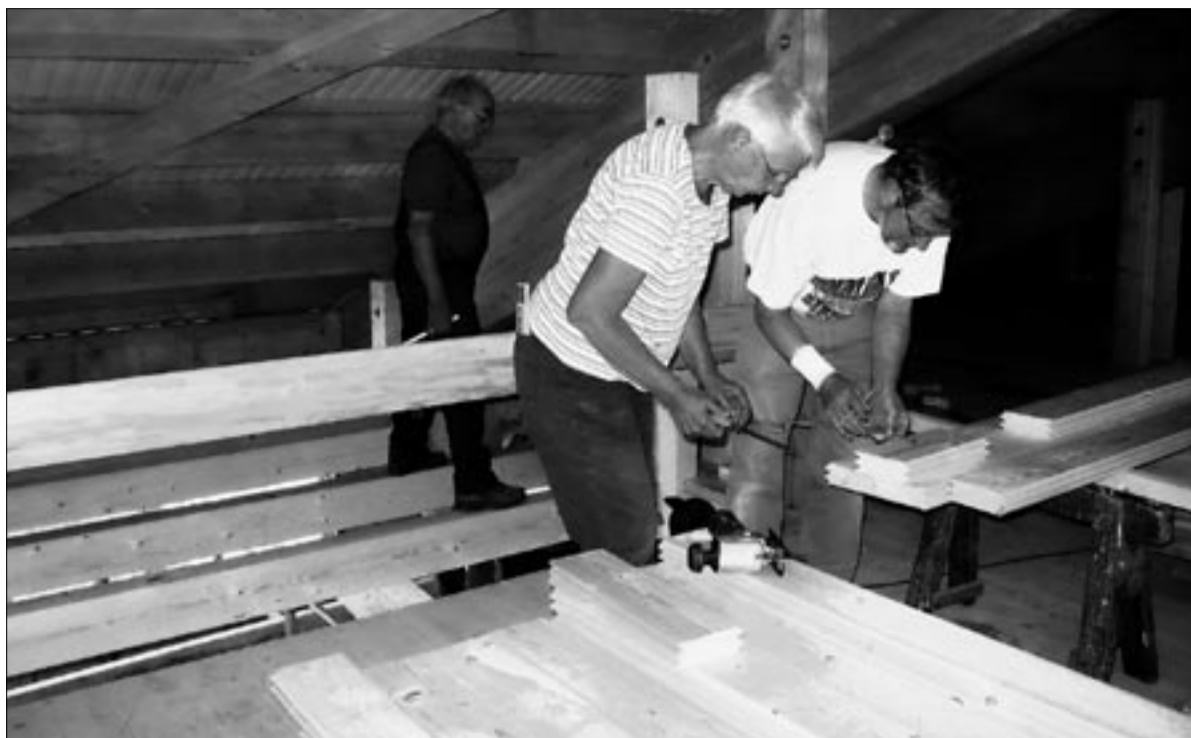
Unissant leurs forces, des artisans de Stäfa collaborent avec des séniors à la construction d'une étable dans les Grisons. (photo mad)
