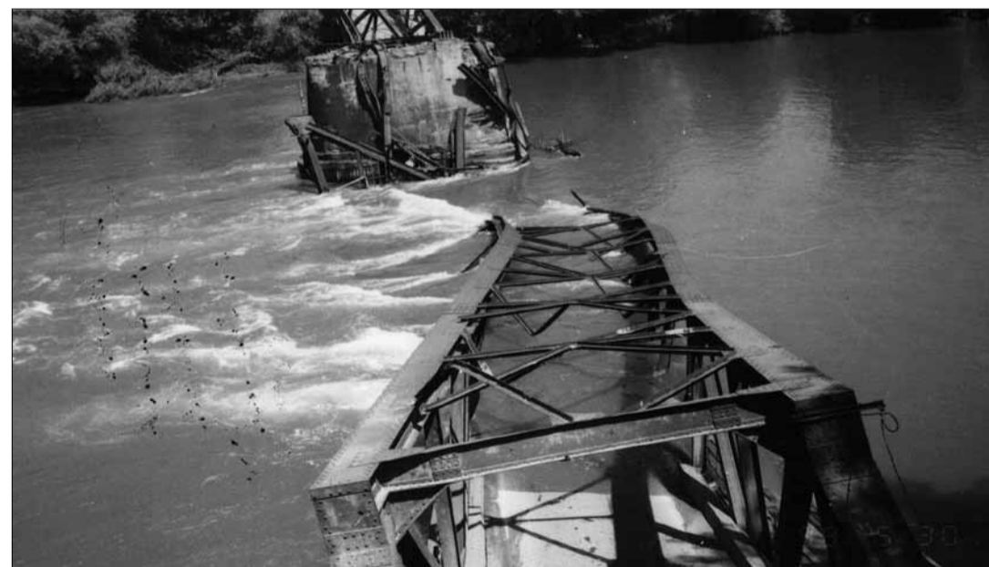
Die Brücke von Varvarin wurde am 30. Mai 1999 schon beim ersten Anflug von zwei Nato-Jagdbombern F 16 vollständig zerstört. Der zweite Anflug kostete 10 Menschen das Leben und hinterliess 27 Schwerverletzte. (Bild zvg)
