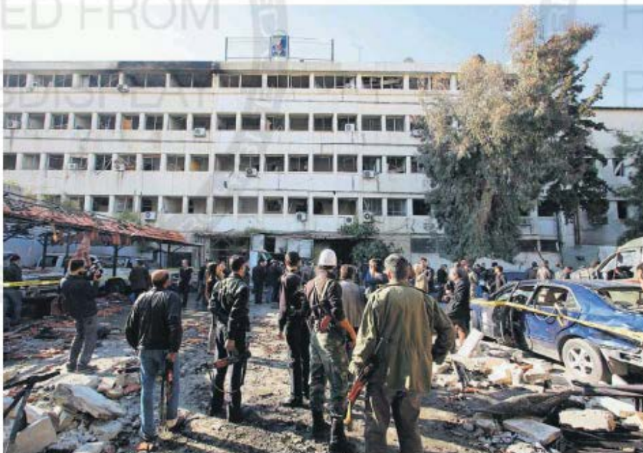
Ein von der Explosion beschädigtes Regierungsgebäude in Damaskus.
